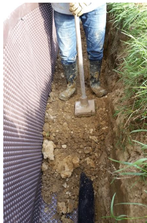
FIGURE N°26 : DAMMAGE MANUEL DES COUCHES DE REMBLAIS
